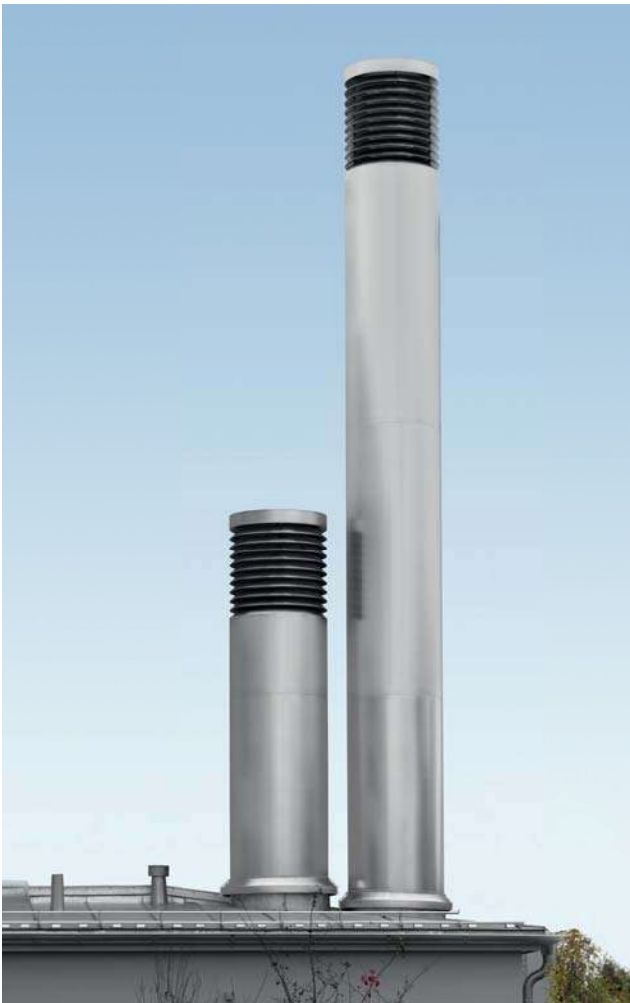
Dobavni i odsisni ventilacijski toranj s prodorom kroz krov
